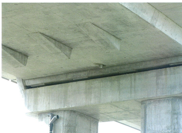
Pilar de transição; Bainhas de reserva de pré-esforço. Transition pier; prestress reserve steel duct.
